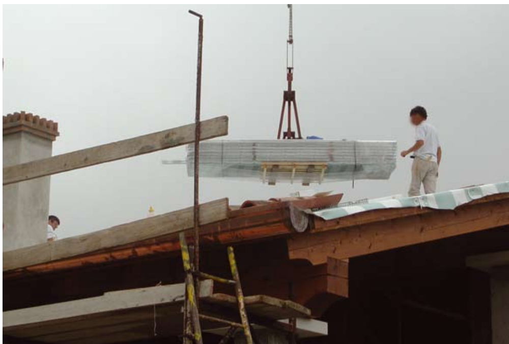
Il lavoratore non indossa i DPI necessari e il ponteggio non è a norma.
