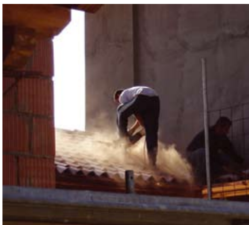
Il posatore non indossa i DPI adeguati al tipo di lavorazione; la lavorazione in oggetto non è in area sicura; il ponteggio non è a norma.
