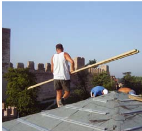
Gli addetti non indossano i DPI adeguati alla lavorazione: mancano guanti, elmetto e indumenti da lavoro idonei.
