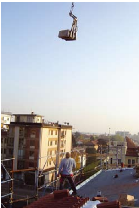
Il montatore si trova in zona pericolosa senza elmetto e a rischio di caduta materiale dall'alto; il ponteggio non è a norma.
