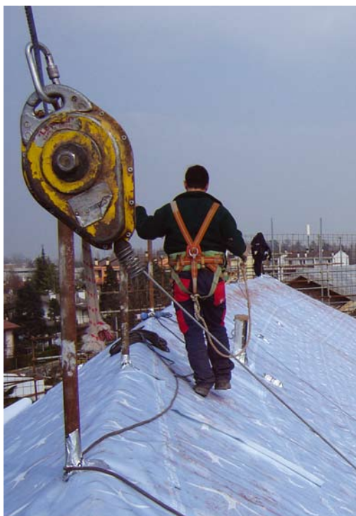
La linea vita non è a norma e il lavoratore non indossa l'elmetto.
