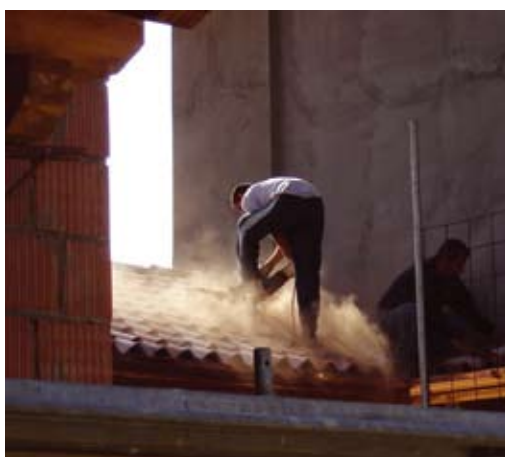
Il posatore non indossa i DPI adeguati al tipo di lavorazione; la lavorazione in oggetto non è in area sicura; il ponteggio non è a norma.
