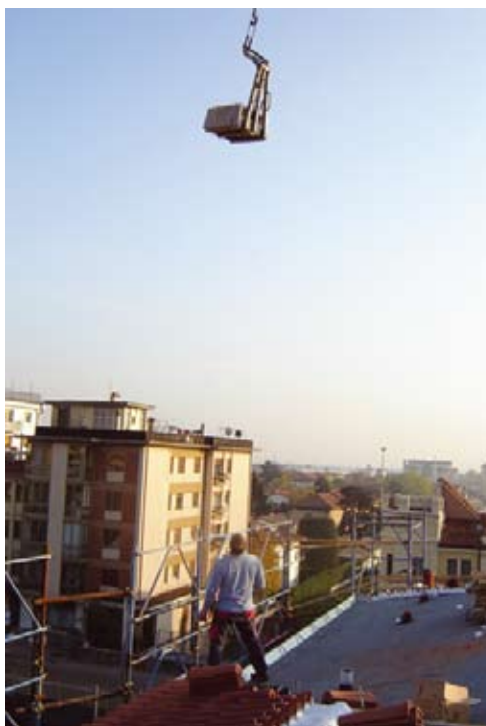
Il montatore si trova in zona pericolosa senza elmetto e a rischio di caduta materiale dall'alto; il ponteggio non è a norma.
