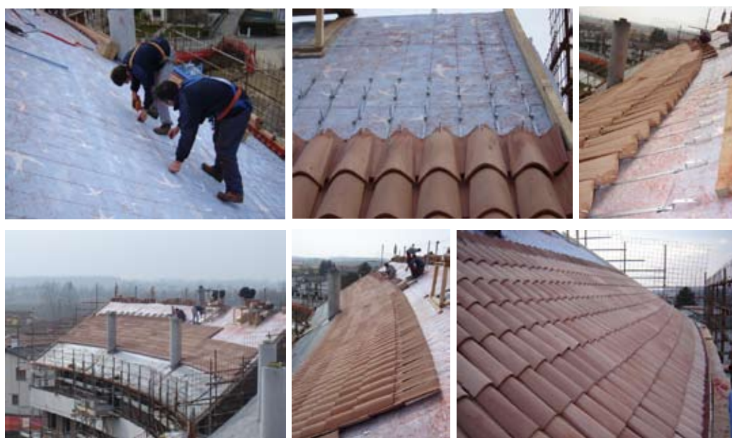
Le fasi di tracciatura per il fissaggio e la posa in opera del manto di copertura in coppi di laterizio.
